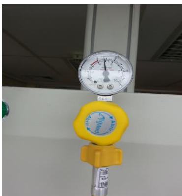
Figura 4: Conexão do ventilador a rede de ar comprimido
