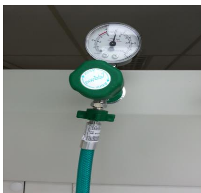
Figura 5: Conexão do ventilador a rede de oxigênio
